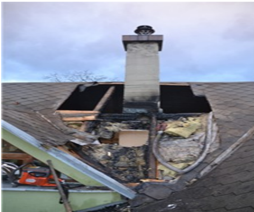
Pohled na požárem zasaženou část střechy
